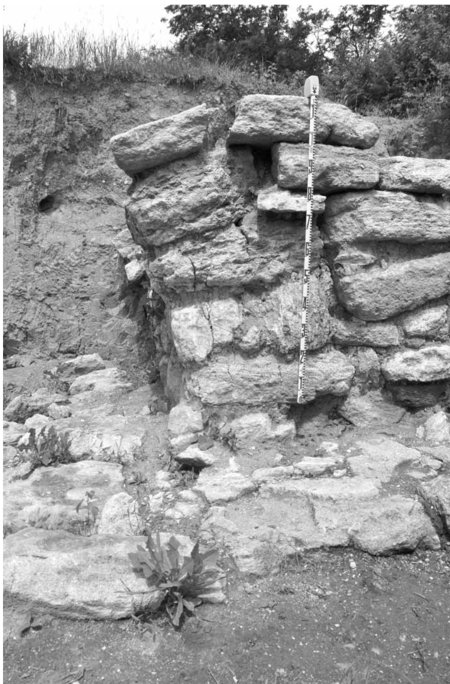
Рис. 5. Сквозная трещина (joint), пробивающая 3 каменных блока насквозь в городской стене (раскоп XXVIII).
