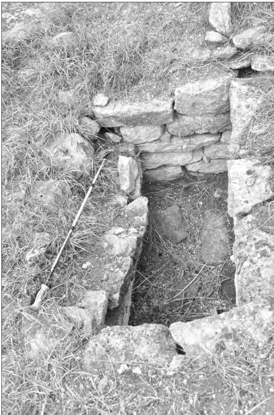
Рис. 7. Нимфей. Участок «Г». Деформированное устье одного из колодцев IV в. до н.э. Западная стена колодца (аз. прост.170°) наклонилась к востоку под углом 80°.
