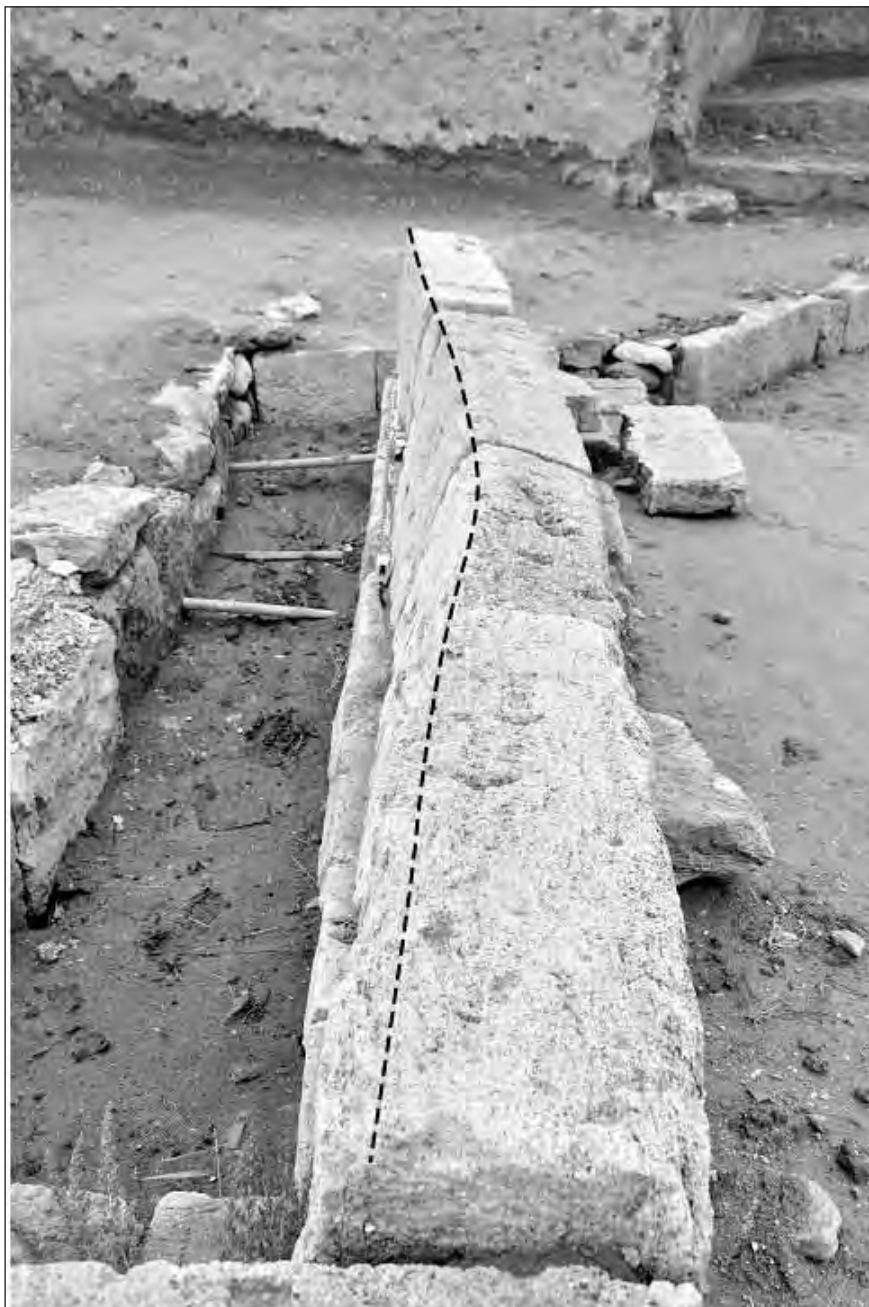
Рис. 5. Горизонтальный изгиб в плане, а также значительный наклон и смещение верхнего ряда каменных блоков (оформление пропилей) над водоотводным лотком к ЮЮВ. Нижний ряд кладки водостока, вкопанный в грунт, почти не поврежден.
