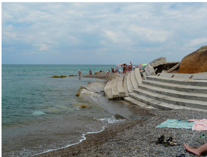
Рис. 2.1.1. Состояние берегоукрепительных сооружений в с.Фрунзе в 2009 году
