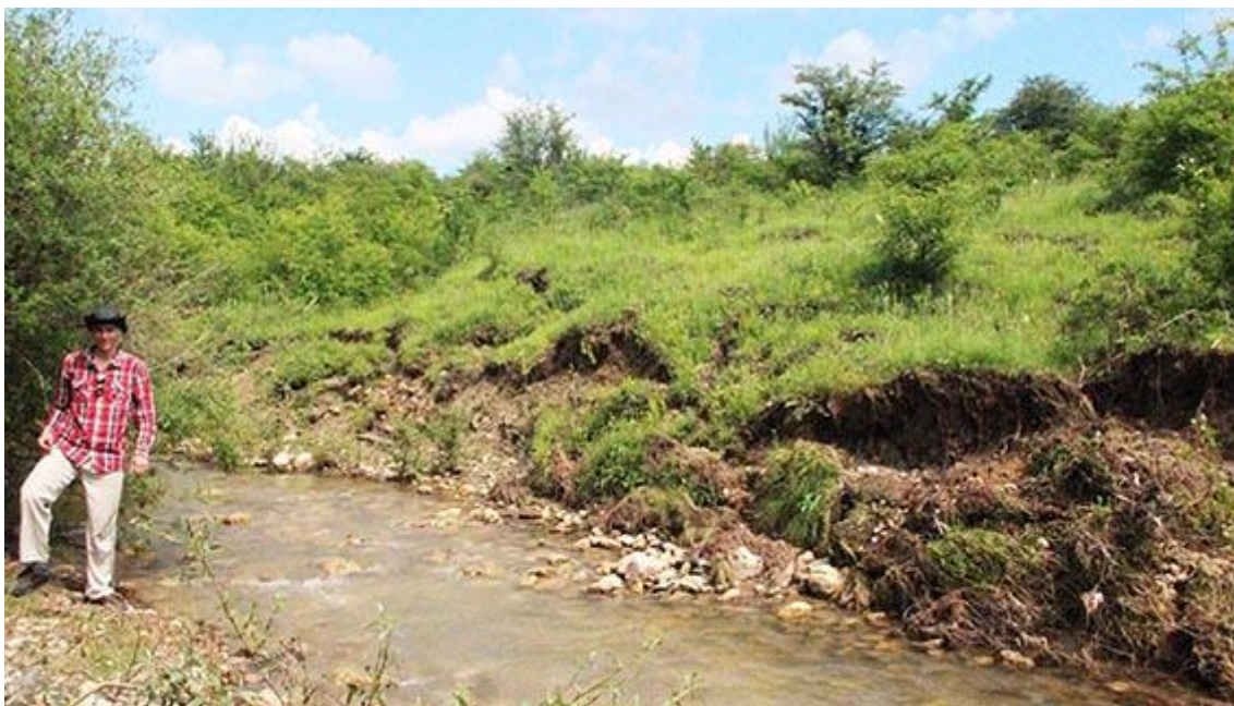
Рис. 18-8. Оползневой склон в правом борту долины руч. Краснопещерного в 0,5-1 км выше устья.
