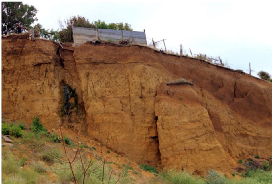
Рис. 10-7. Строение оползневого цирка в районе Учкучевки. Вверху – схема обнажения: 1 – известняки, 2 – суглинки, 3 – супеси, 4 – галька, 5 – пески и песчаники, 6 – перемятые породы таврской свиты, 7 – глыбы. Внизу – блок отседания в оползневом цирке. На краю склона постройки, увеличивающие нагрузку на склон.
